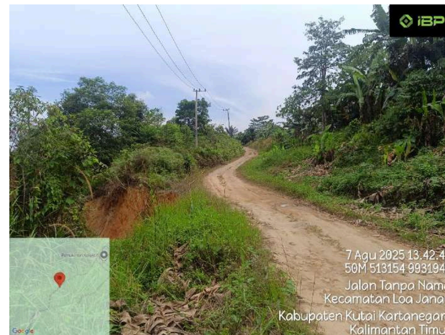
Sebelum pengalihan jalan sementara akibat longsor RT 13.
